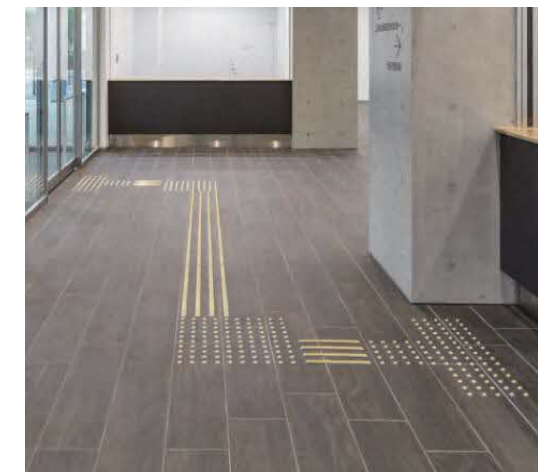
誘導ブロックの例
