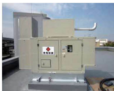
非常用自家発電設備
