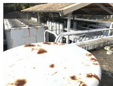
42年間稼働している空調設備
