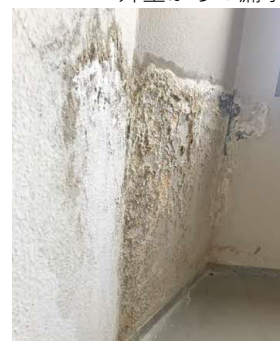
外壁からの漏水
