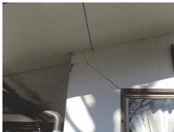
例2）外壁の一部にひびが生じた
