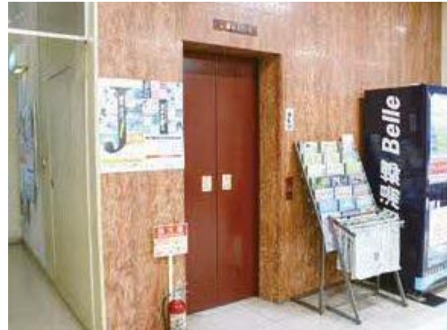
部品供給が困難なエレベーター
