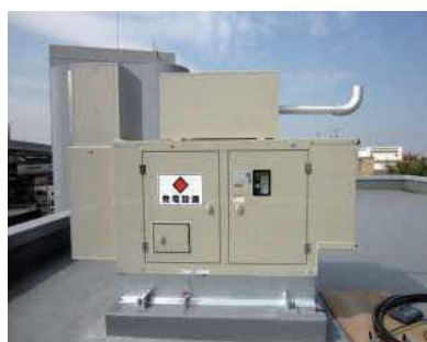
非常用自家発電設備
