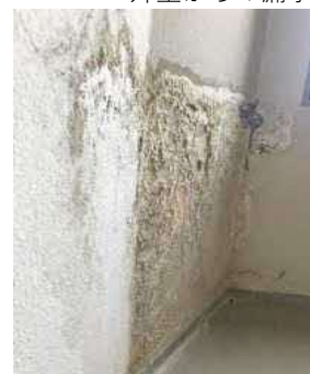
外壁からの漏水
