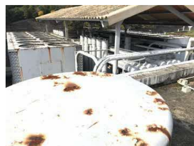
42年間稼働している空調設備
